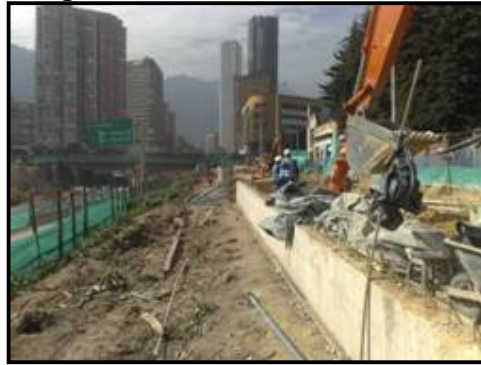
Imagen 8 Calzada sur calle 26
