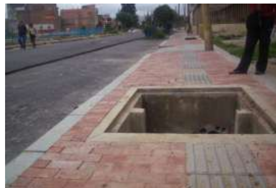
Imagen 6. Obra sin terminar ni señalizada
