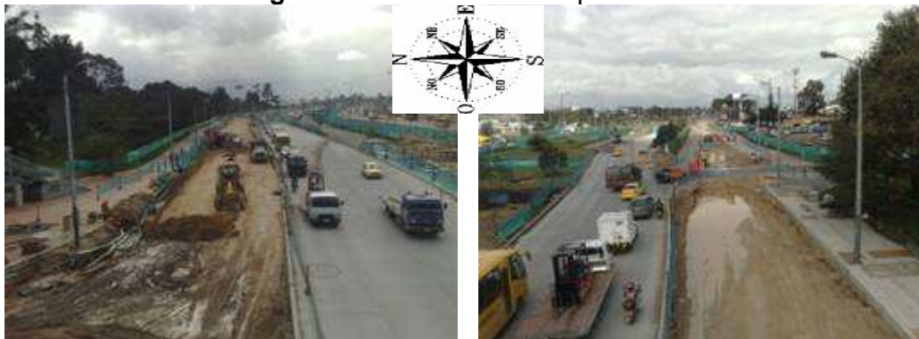
Fuente: CCB. Visita técnica de octubre 28 de 2010. Calle 26 x Carrera 94 (Sentido Occidente – Oriente)
