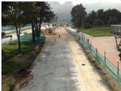
Fuente: CCB. Visita técnica de octubre 28 de 2010. Calle 26 x Carrera 94 (Sentido Occidente - Oriente)
