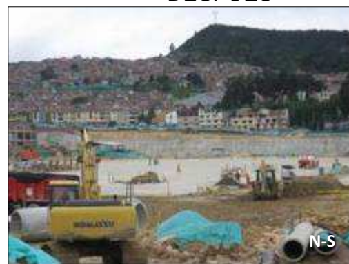
Fuente: CCB. Visita técnica del 29 de abril de 2010.
