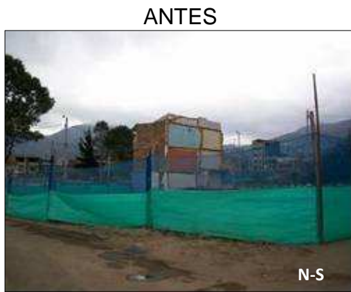
Fuente: CCB. Visita técnica del 17 de abril de 2009. Carrera 9 x 31Sur.
