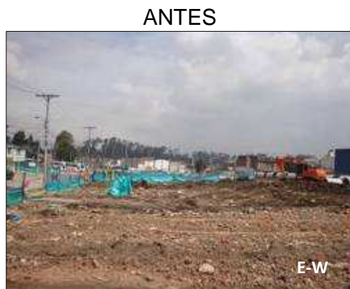
Fuente: CCB. Visita técnica del 3 de abril de 2009. Carrera 9 x 31Sur.
