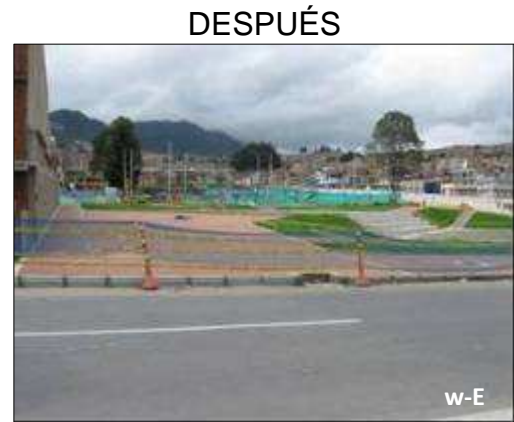
Fuente: CCB. Visita técnica del 29 de abril de 2010. Carrera 9 x 31Sur.
