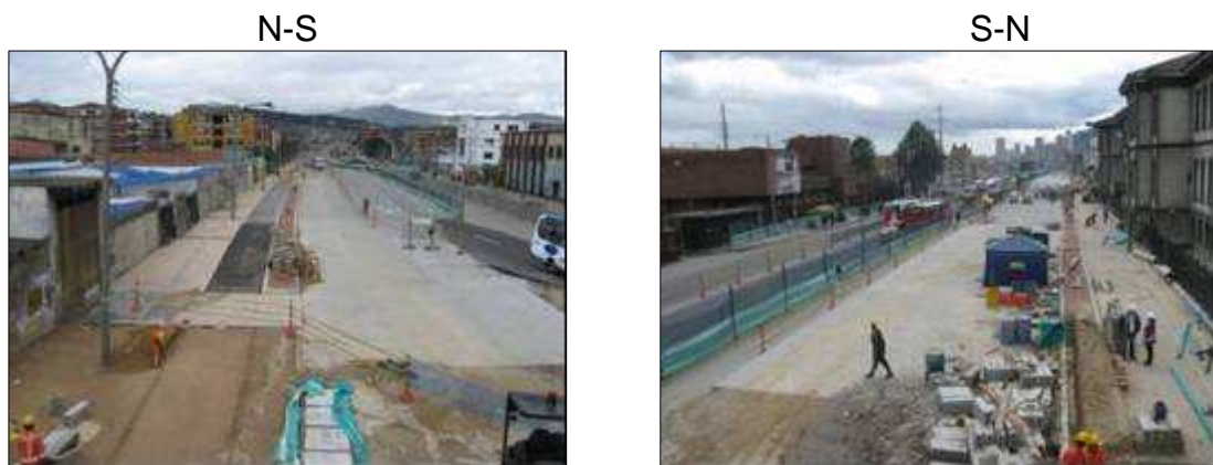
Fuente: CCB. Visita técnica del 29 de abril de 2010.
