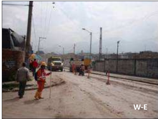
Fuente: CCB. Visita técnica del 17 de abril de 2009.
